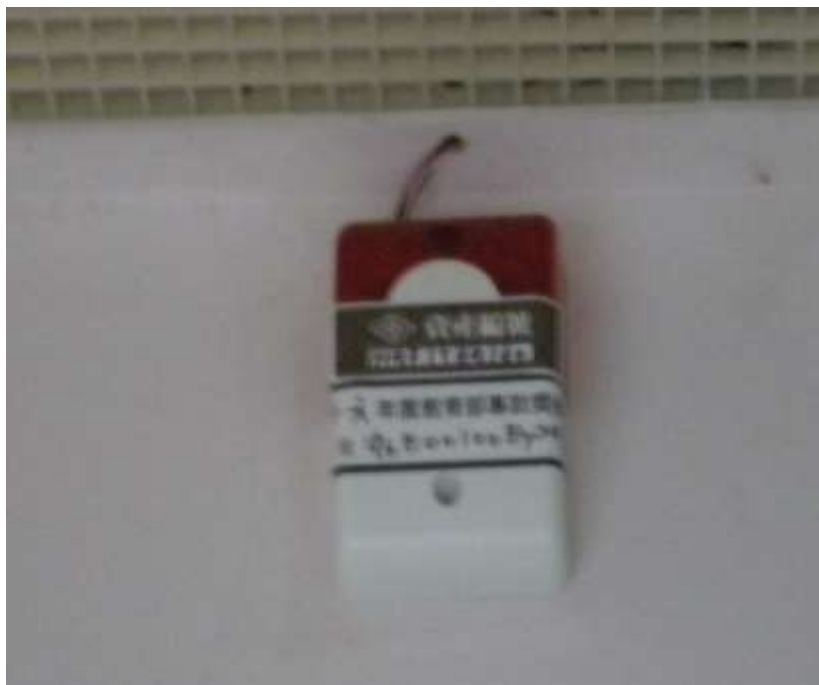
每間廁所及寢室緊急警報
