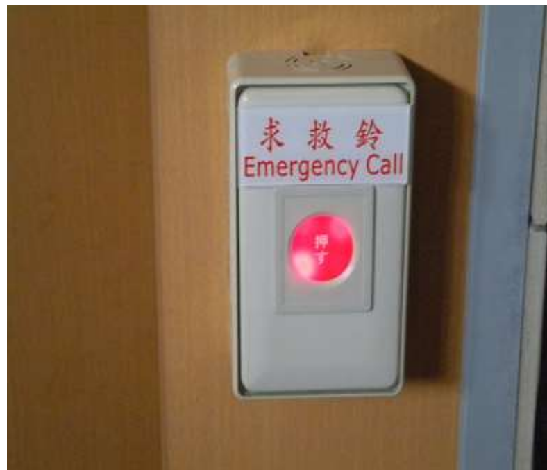
每間廁所及寢室緊急按鈕
